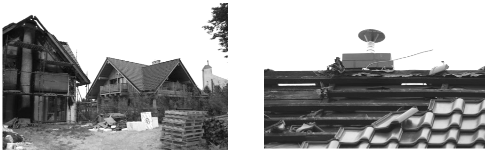
Rys. 4. Szkody wywołane w budynku bezpośrednio uderzonego piorunem. Nieprawidłowe wymiary zwodu pionowego – zbyt duży kąt ochronny
