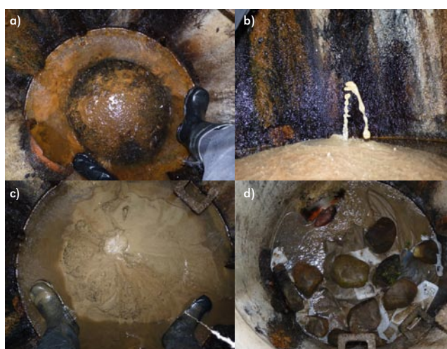
Rys. 12. Studnia z zakolmatowaną geowłókniną: a) stan zastany, b) wypływ wody przez rozdarcie, c) upłynięcie podłoża pod studnią, d) doraźne zabezpieczenie przed wynoszeniem podłoża
