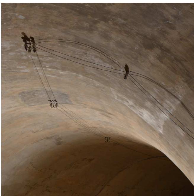
Rys. 4. Ogólny wygląd instalacji (widoczny fragment ma rozpiętość około 6 m)
