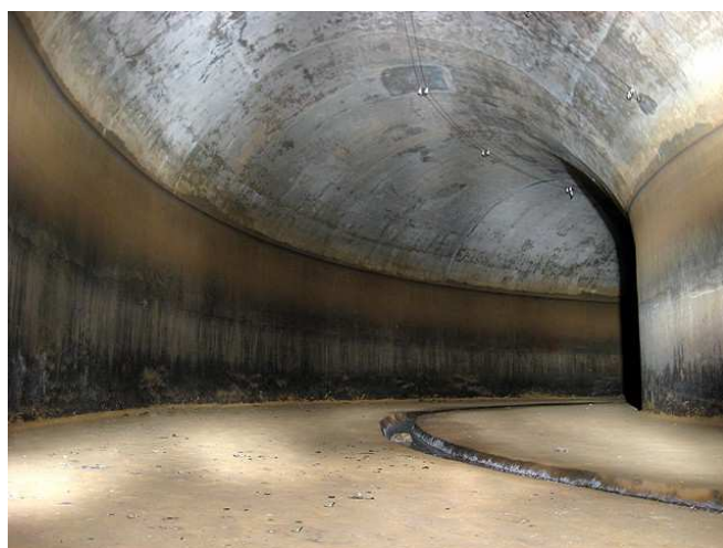
Rys. 1. Komora K1, środkowy pierścień zbiornika, pod sklepieniem widoczne przewody prowadzone na izolatorach
