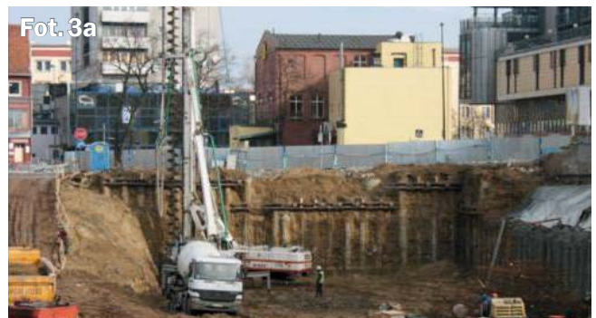
Fot. 2. Palisada przy realizacji zabudowy mieszkalnej „Brama Brętowska” w Gdańsku (wyk. i fot. Fundament Specjal)
