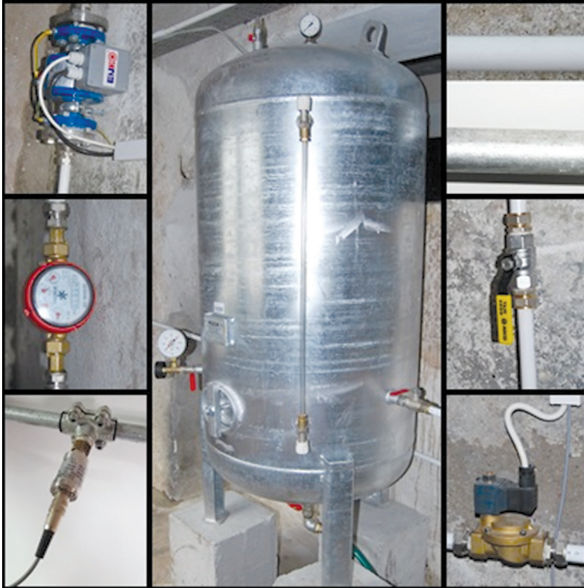
Ryc. 2. Fotografie wybranych elementów stanowiska pomiarowego: prawy górny róg – przewody, dla jakich wykonywano pomiary, prawy dolny róg – zawór elektromagnetyczny, środek po prawej stronie – zawór kulowy, środek – zamknięty zbiornik hydroforowy, lewy górny róg – przepływomierz elektromagnetyczny, lewy dolny róg – tensometryczny czujnik ciśnienia Fig. 2. Photographs of selected elements of the test bench: upper right corner – pipe for which measurements were obtained, bottom right corner – electromagnetic valve, center to the right – off valve, center – closed pressure tank, upper left corner – electromagnetic flowmeter, bottom left corner – pressure strain gauge, center of the left – wing water-meter.
