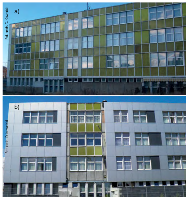
Rys. 4. Budynek hotelowy z lat 70. ubiegłego wieku: a) obiekt przed renowacją z systemową lekką elewacją z okresu budowy typu Bistyp, b) w trakcie renowacji w roku 2016
