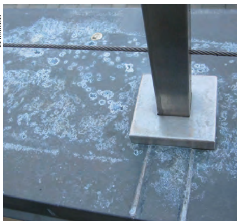
Rys. 6. Wykwity białej korozji cynku na blachach tytanowo-cynkowych
