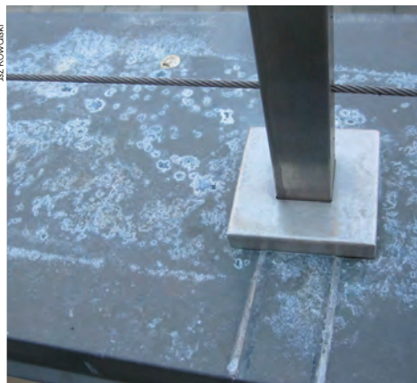
Rys. 6. Wykwity białej korozji cynku na blachach tytanowo-cynkowych
