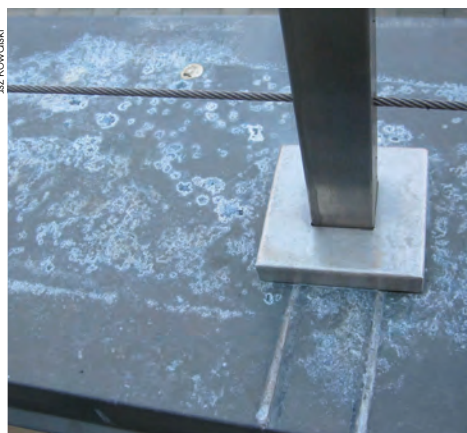
Rys. 6. Wykwity białej korozji cynku na blachach tytanowo-cynkowych
