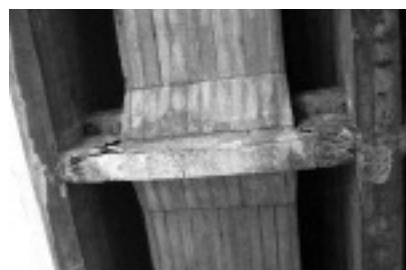
Ścięte poprzecznicę w przęsle zachodnim [9] Shear damage of crossbeam in the western span [9]
