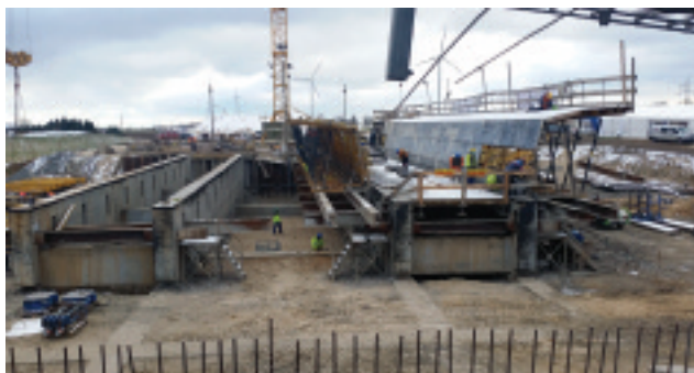
Fot. 1. Wytwórnia zlokalizowana za przyczółkiem (widok od strony przyczółka) [Fot. K. Żółtowski] Photo 1. Fabrication station localised behind abutment (view from abutment)
