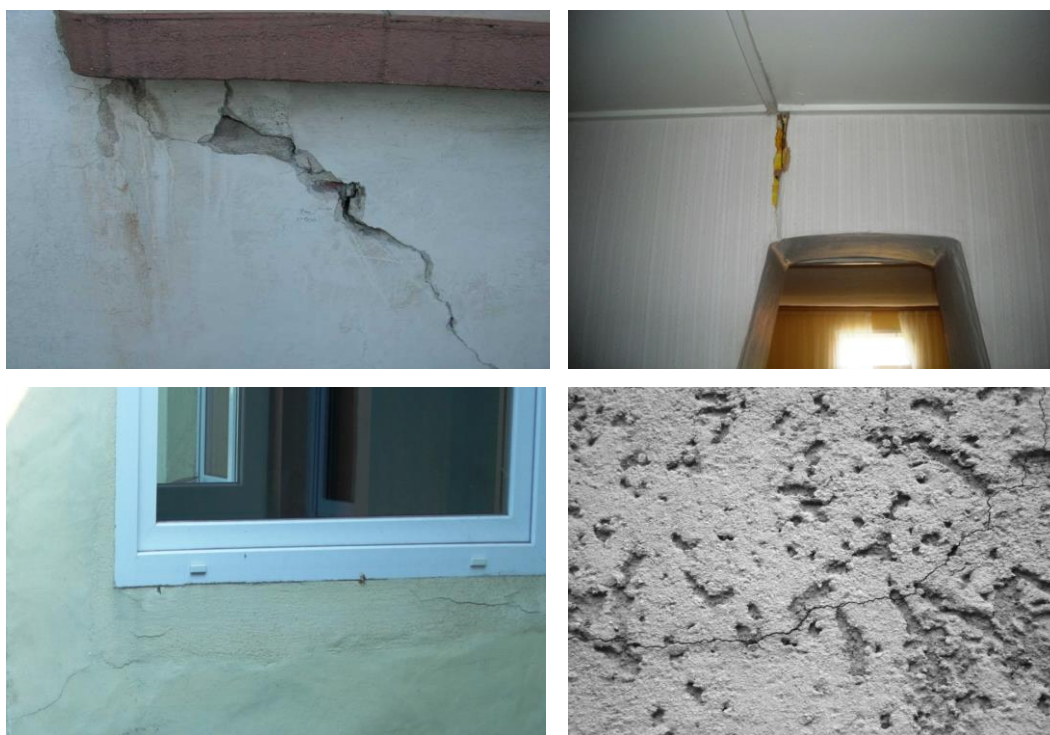
Rys. 2.1. Uszkodzenia powstałe na skutek drgań komunikacyjnych.
