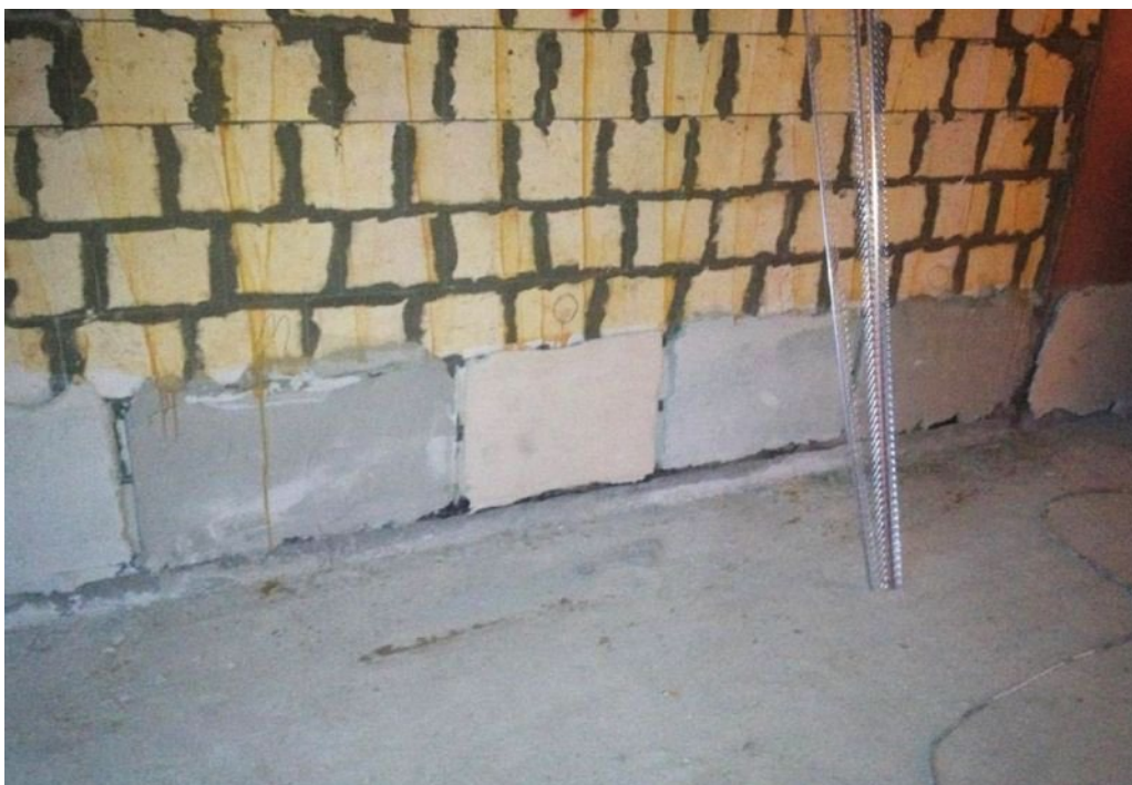
FOT. 1. Widok próbek (poetek tynkarskich) wykonanych na murze z bloczków silikatowych (podłoże wapienno-piaskowe); fot.: autorzy
