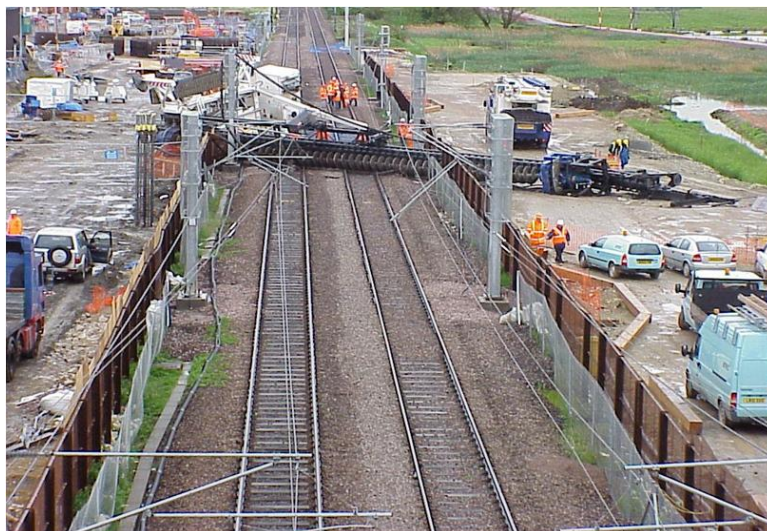
Fotografia 1.3 Wypadek na placu budowy Channel Tunnel Rail Link Contract 310 (PFSF, 2008)
