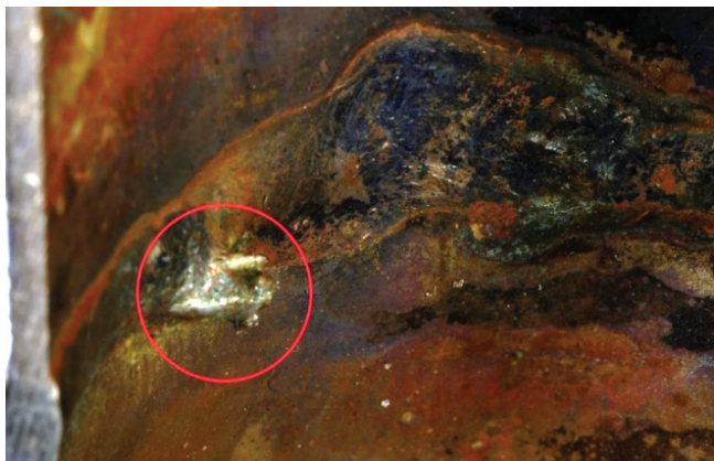
Rys. 5. Wada spawalnicza – w spoinie widoczne są części elektrody spawalniczej
