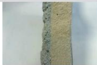
FOT. 7. Przekrój poprzeczny przez warstwy odparzonego tynku; fot.: autorzy
