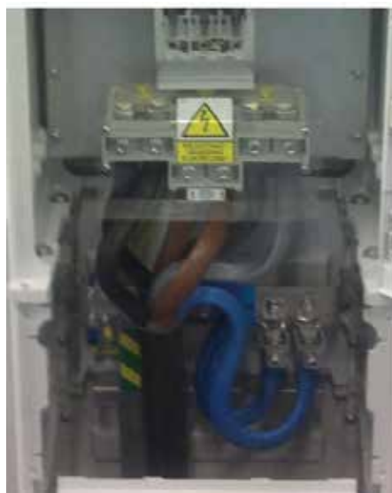
Rys. 8. Widok kabla typu YAKXS 4 x 240 mm 2 przyłączonego do zacisków rozłącznika bezpiecznikowej z przekroczeniem promienia gięcia. Źródło: archiwum M. Schwann
