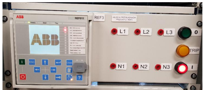
Rys. 3. Front pola z przekaźnikiem zabezpieczeniowym
