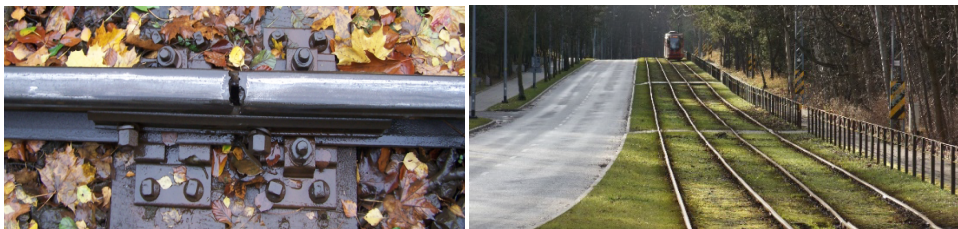
Rys. 4. Przykłady krytycznego i bardzo złego stanu technicznego torów tramwajowych
