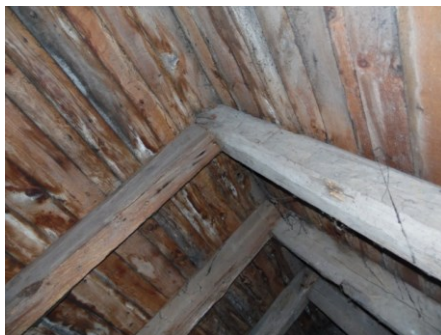
Fot. 9. Nowa Kościelnica – połączenie krokwi. (fot. autor)
