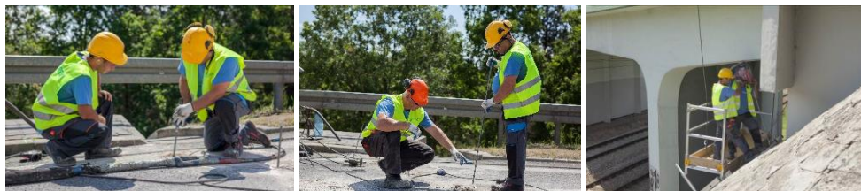
Rysunek 7 Wzmocnienie gruntu pod przyczółkami wiaduktu drogowego na drodze krajowej nr 12 poprzez iniekcje geopolimerowe (Geobear sp. z o.o.)
