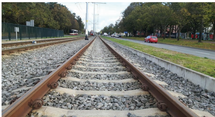
3. Stan toru oraz przeszkody terenowe na odcinku a
