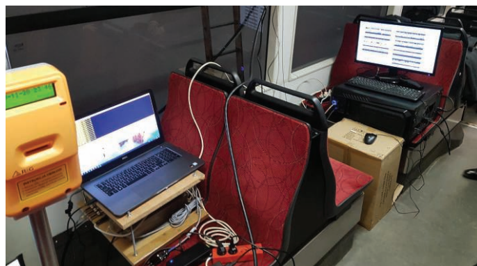
10. Kontrolery systemu akcelometrów i inklinometru oraz kompasu GNSS
