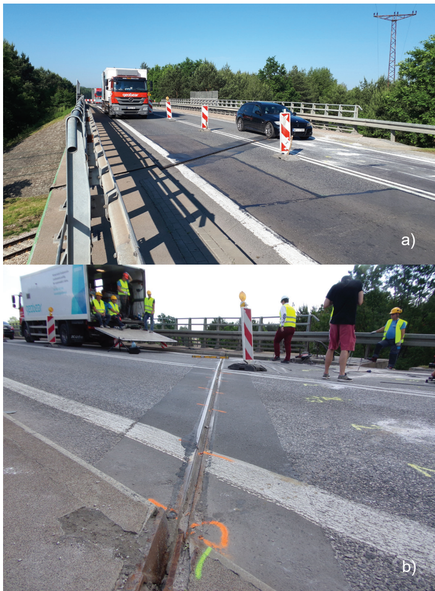
Fot. 2. Progi na dylatacji modułowej spowodowane osiadaniami nasypu (Geobear Sp. z o.o.)
