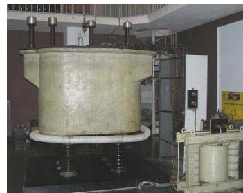
Rys. 7. Transformator TPZ 160 kV 300 kVA przerobiony z niemieckiego transformatora 200 kV z TH Breslau wykorzystywany w latach 1962-2014 [5]
