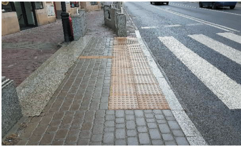
Rys. 5. Przykład nieprawidłowości stosowania urządzeń dla osób ze szczególnymi potrzebami – nagromadzenie nieprawidłowości i deficytów Źródło: fotografia własna
