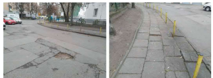
Fot. 11. Zły stan techniczny drogi i chodnika przy Przedszkolu nr 49 „Miś” (fotografie – zasoby własne autorek)
