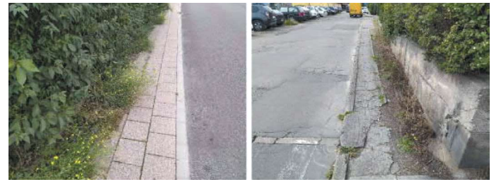
Fot. 10. Roślinność zabierająca przestrzeń chodnika oraz zły stan techniczny chodnika na ulicy Łęborskiej (fotografie – zasoby własne autorek)
