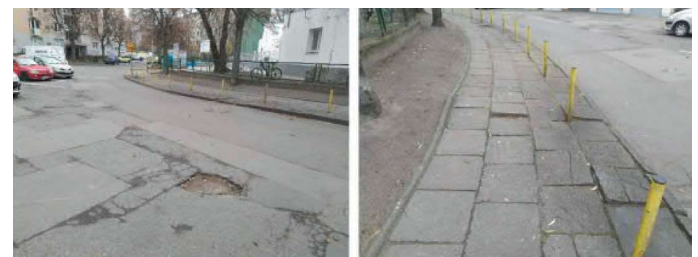
Fot. 11. Zły stan techniczny drogi i chodnika przy Przedszkolu nr 49 „Miś” (fotografie – zasoby własne autorek)
