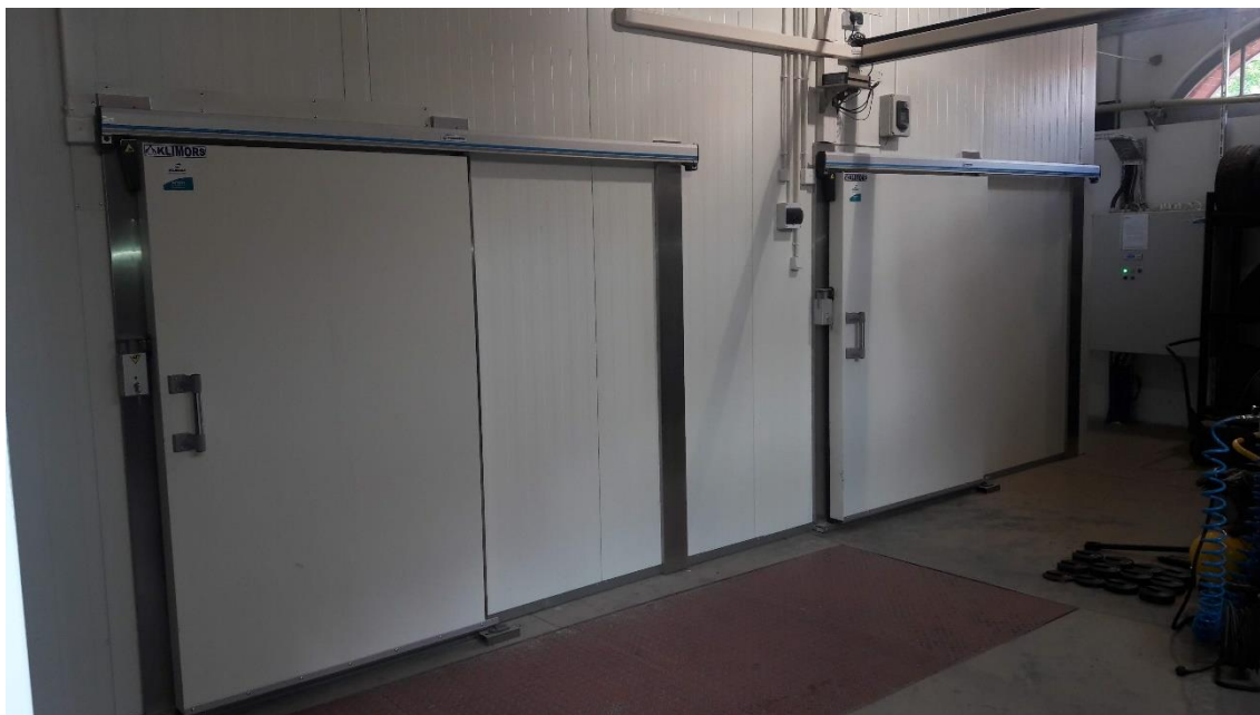
Rysunek 15. Komora termostatyczna stosowana w laboratorium Zespołu Pojazdów Politechniki Gdańskiej (materiał własny)
