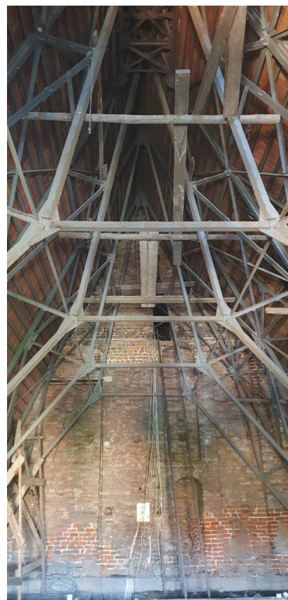
Rys. 5. Konstrukcja stalowa przekrycia nad prezbiterium w nawie środkowej kościoła pw. Świętych Apostołów Piotra i Pawła w Gdańsku
