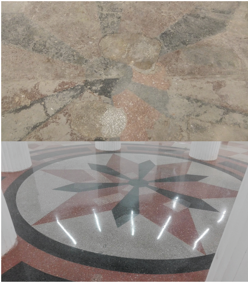
Fot. 4. Posadzka typu lastrico przed i po naprawie [M3]
