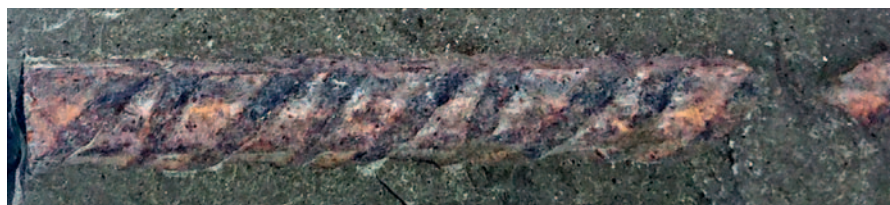
Fot. 6. Widok na pręt bez ochrony katodowej, widoczna korozja całej powierzchni pręta [źródło: Marcin Majewski]
