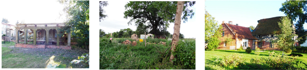
Fig. 2. Destruction of arcaded houses: a) Lasowice Małe, b) Kławki, c) Świerki ( photo by the author )
