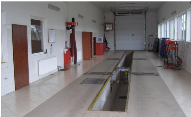
Rys. 6.4. Stanowisko kontrolno-pomiarowe firmy CARTEC w Stacji Kontroli Pojazdów w Gdańsku
