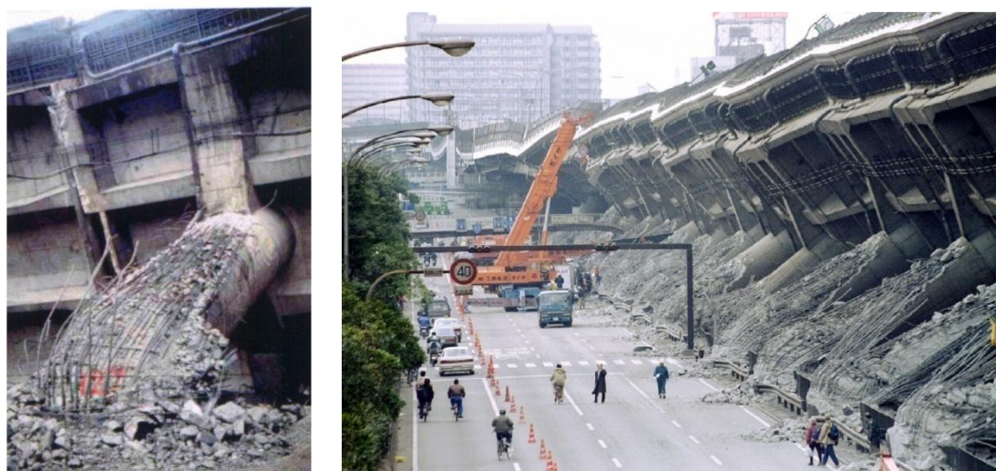
Rys. 1 Zniszczenie wiaduktu trasy Hanshin po trzęsieniu ziemi Kobe ([R1] JSCE 1995)
