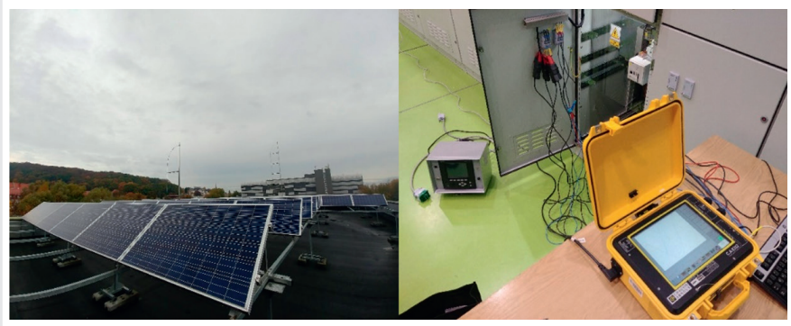
Fot. 1. Zdjęcia a) badanej instalacji fotowoltaicznej (z lewej) b) stanowiska pomiarowego (z prawej)
