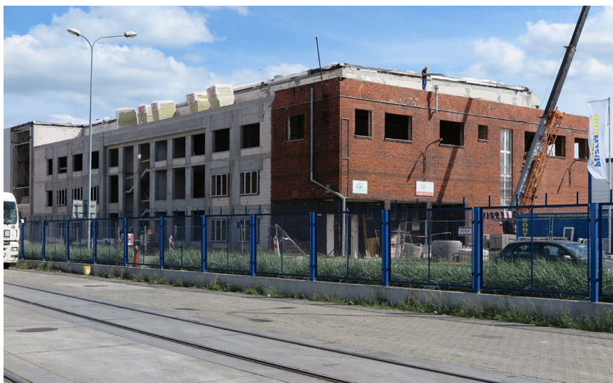
Fot. 3. Budynek firmy „Bananas” przy ul. Polskiej 21 w trakcie remontu części zachodniej (część ceglana) i odbudowy części północnej (część z lewej strony), 2016 r., fot. R. Hirsch
