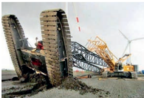
Fot. 1. Wyrócenie maszyny spowodowane awarią platformy roboczej
