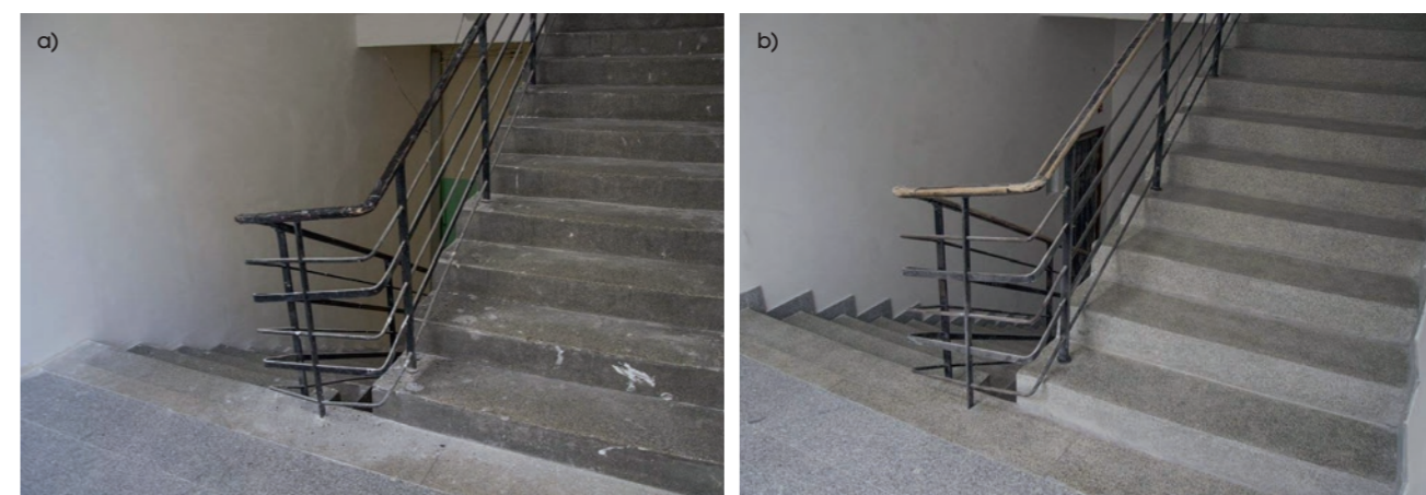
Fot. 1. Renowacja i naprawa posadzki typu lastrico w wielorodzinnym budynku mieszkalnym – posadzka: a) przed naprawą, b) po naprawie (M1)
