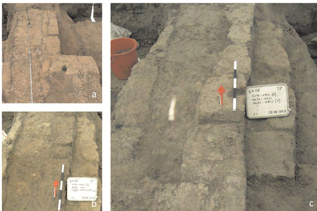
Rycina 32. Pęknięcie podłużne wschodniego fundamentu (F.2873/F.3161) budynku B.95 (fot. A. Leszczewicz).
