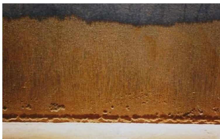
Rys. 1.15. Uszkodzenia korozyjne płaszcza zbiornika ( V = 12\ 000\ m^3 ) w strefie połączenia płaszcza z dnem [12]
