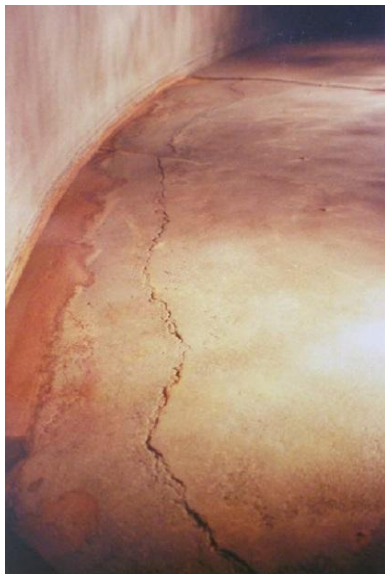
Rys. 1.12. Wżer korozyjny w dnie zbiornika w miejscu zawalcowania wtrąceń niemetalicznych (siarczaków)
