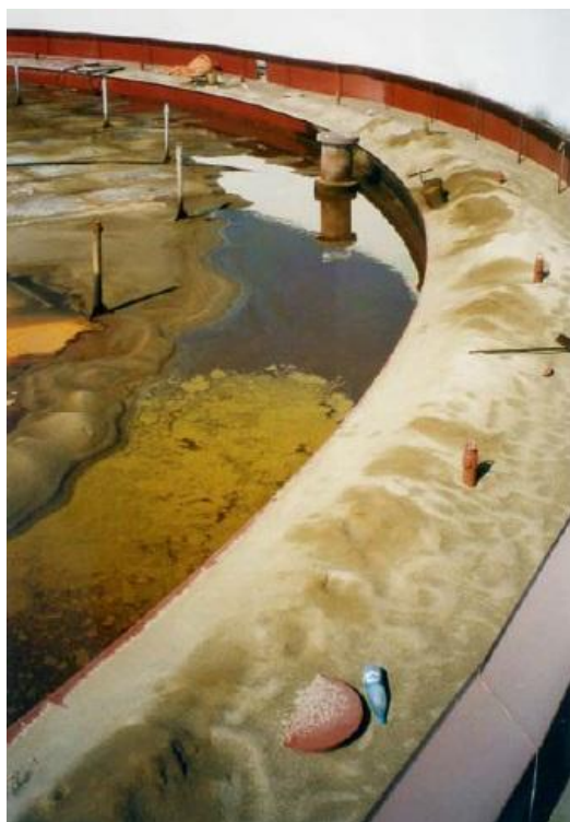
Rys. 1.23. Wywołująca korozję woda z opadów atmosferycznych zalegająca przy połączeniu membrany dachu pływającego z pontonem [12]
