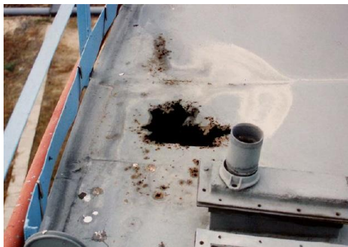
Rys. 1.22. Zniszczenia korozyjne blach pokrycia dachu stałego zbiornika w strefie często otwieranego króćca [12]
