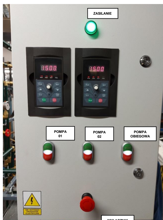
Rys. 6. Widok ogólny rozdzielni zasilająco-sterującej stanowiska laboratoryjnego do badania pomp wirowych
