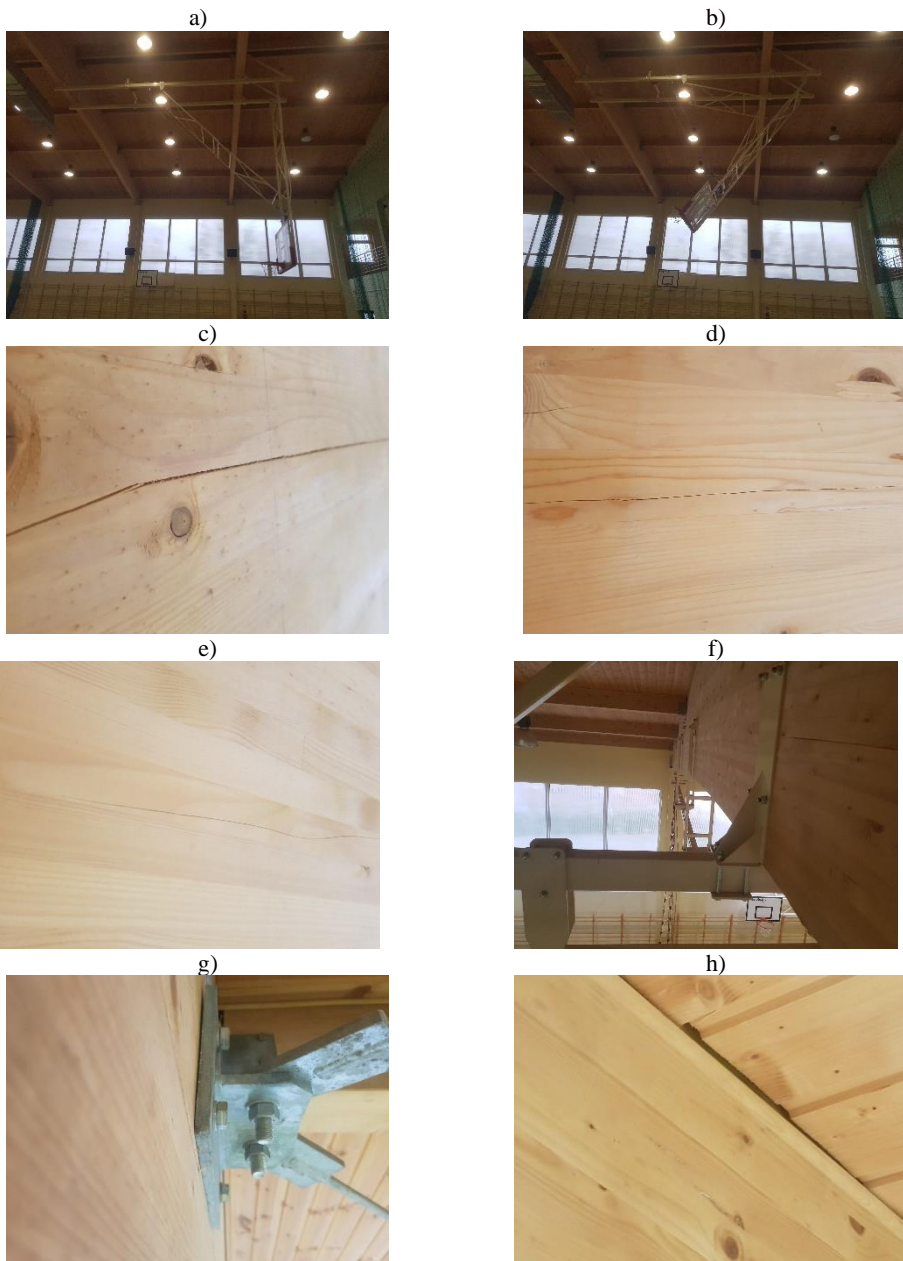
Rys. 2. Sala sportowa: a), b) widok wnętrza z pokazaniem dźwigarów dachowych z drewna klejonego oraz etapów podnoszenia konstrukcji stalowej do mocowania tablic do koszykówki, spękania dźwigara dachowego: c) pomiędzy warstwami klejonych lameli (delaminacja desek), d) w grubości pojedynczego lamela (rozszczepienie drewna wzdłuż włókien), e) ukośne pęknięcie pojedynczego lamela, zdeformowane blachy węzłowe: f) konstrukcji wsporczej tablic do koszykówki, g) stężeń dachowych w miejscu ocowania w płaszczyźnie bocznej dźwigarów, h) uszkodzenia podsufitki w obszarze płatwi dachowej
