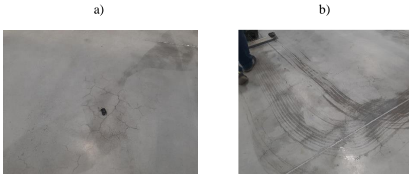
Rys. 7. Widok odspojenia warstwy z suchej posypki utwardzającej DST od podkładu betonowego ( fol. S. Świątek-Żołyńska )
