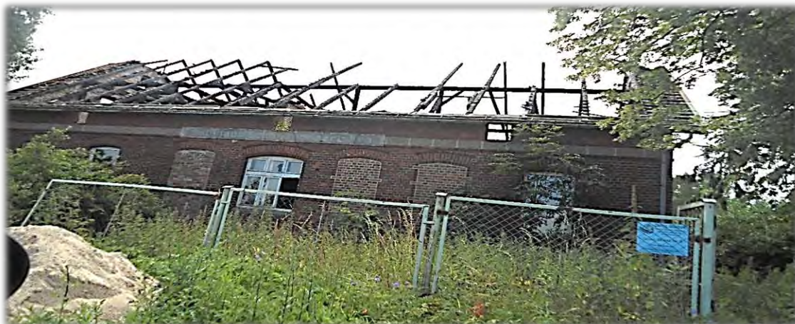
Ryc. 3.4. Spalony budynek (mieszkalny?) w okolicy wsi Ostaszewo przy wale wiślanym, fot. A. Rubczak, 2017.
