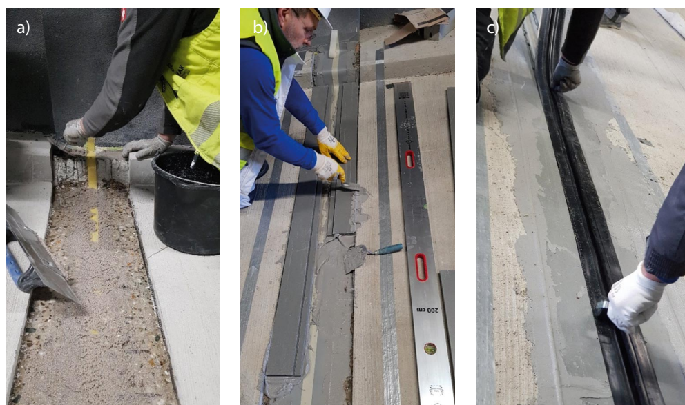
Rys. 11. Etapy naprawy dylatacji konstrukcyjnej: a) reprofilacja ubytków, b) ułożenie kleju montażowego, wklejenie membrany i paneli dylatacyjnych, c) wklejenie nakładki gumowej [26]
