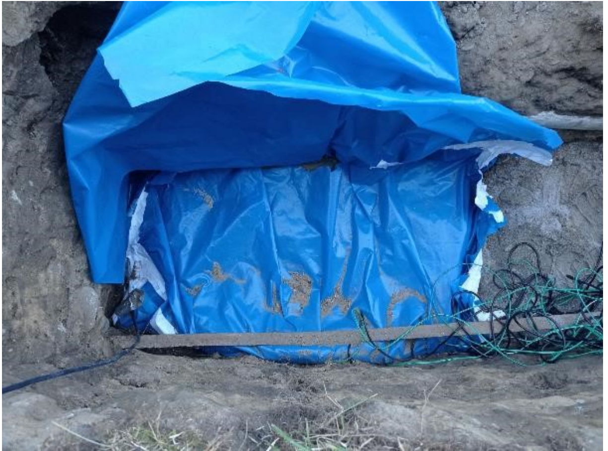
Rysunek 46. Proces owijania betonitu w folię paroizolacyjną. Szczególną uwagę zwrócono, by nie powstały „kieszenie” z folii, w których mogłaby osiadać wilgoć
