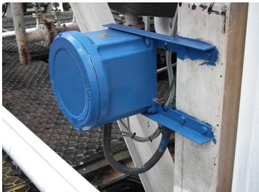
Rysunek 45. System elektroniczny monitorowania korozji zlokalizowany w rejonie zbiornika wody złożowej.
