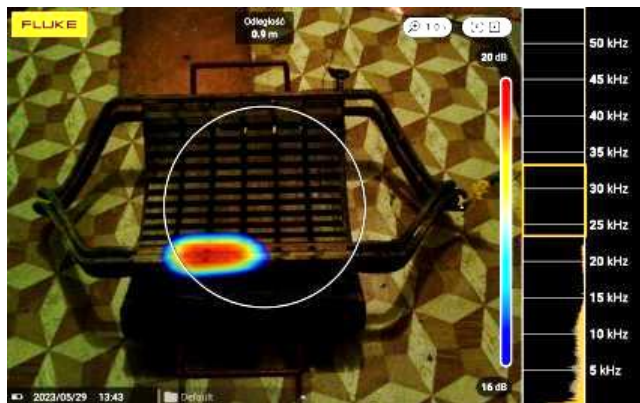
Rys. 6. Lokalizacja WNZ w cewce z 1973 roku przy napięciu przemennym 3,5 kV (znamionowe napięcie fazowe U_{IN} = 3,46 kV)
