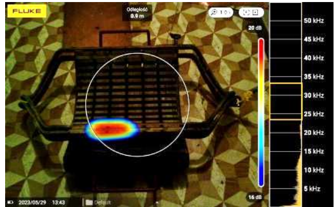
Rys. 6. Lokalizacja WNZ w cewce z 1973 roku przy napięciu przemiennym 3,5 kV (znamionowe napięcie fazowe U_{IN} = 3,46 kV)
