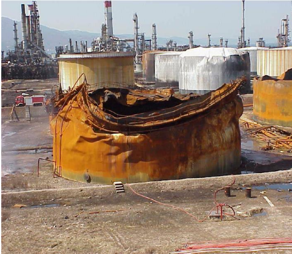
Rys. 2.6. Uszkodzenia zbiornika na benzynę w rafinerii Tüpraş podczas trzęsienia ziemi z dnia 17.09.1999, Kocaeli, Turcja ( http://www.researchgate.net )
