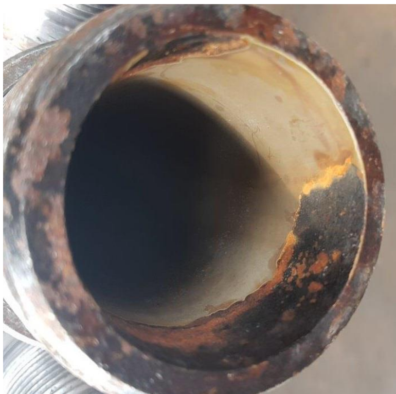
rys. 2.2. Powłoka rury wydobywczej zdegradowana na skutek wielokrotnych interwencji serwisowych w odwiercie. Zdjęcie wykonane dzięki uprzejmości pracowników PGNiG.
