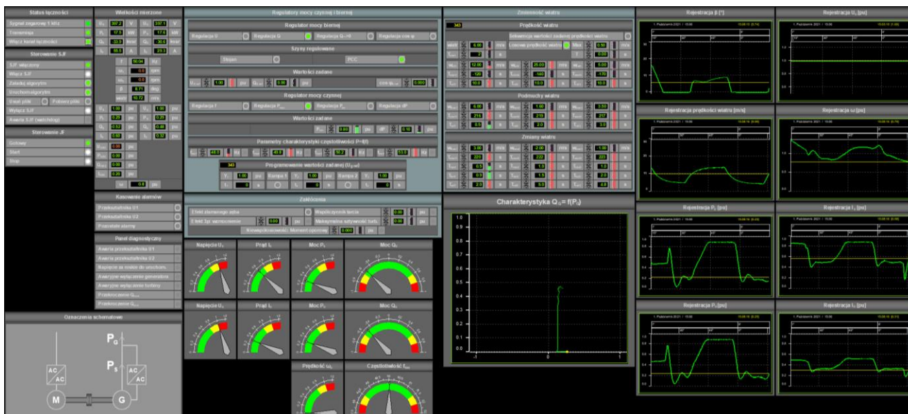
Rys. Z.26. Widok panelu sterującego WTE w systemie SCADA Laboratorium LINTE 2
