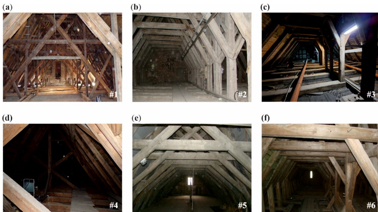
Fig. 5 Roof trusses in: a Miłobądz (#1), b Pruszcz Gdański I (#2), c Kieźmark (#3), d Pruszcz Gdański II (#4), e Kozłiny (#5), f Trutnowy (#6)
