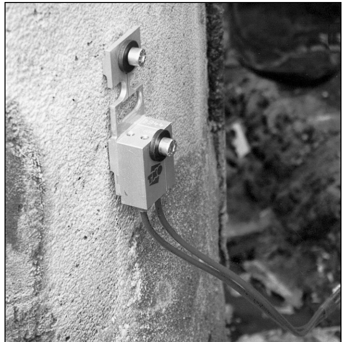
Rys. 1 Czujnik zamontowany na głowicy pala
